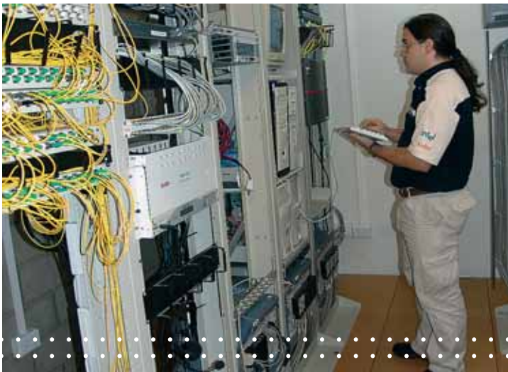
EMPRESA DE TELECOMUNICACIONES / TELECOMMUNICATIONS COMPANY
