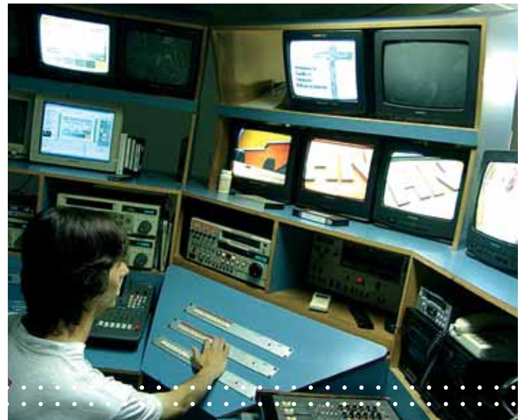
SALA DE EDICIÓN. SEÑAL DE CABLE LOCAL / LOCAL TELEVISION CABLE EDITING ROOM.
