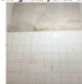
Foto grieta pared Oeste
