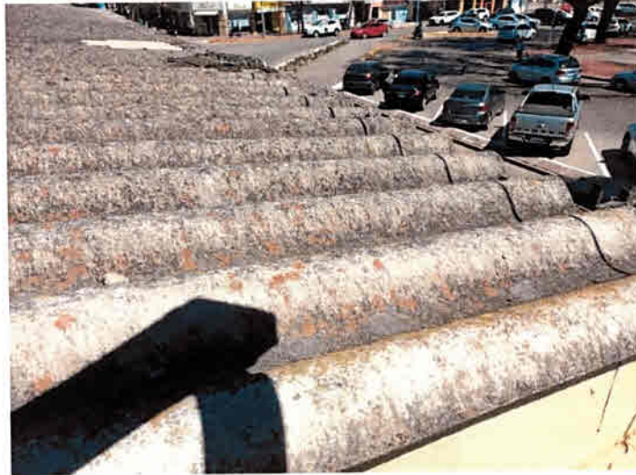
Figura 3: Estado de la cubierta
