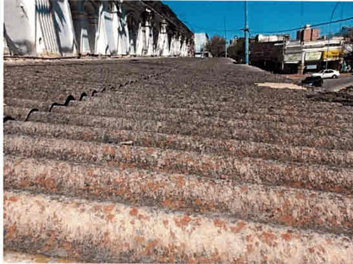
Figura 5: Estado de la cubierta
