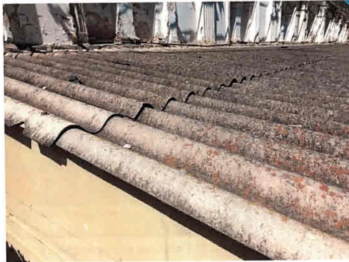
Figura 4: Estado de la cubierta
